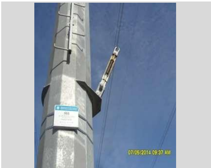
Разрушенный талреп ветровой связи
