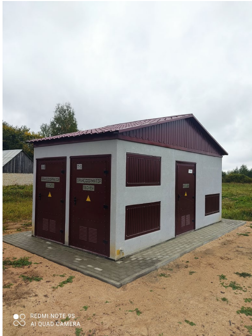
Комплектная трансформаторная подстанция в бетонной оболочке
