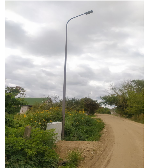
Вид улицы с опорой освещения и ЩУЭ
