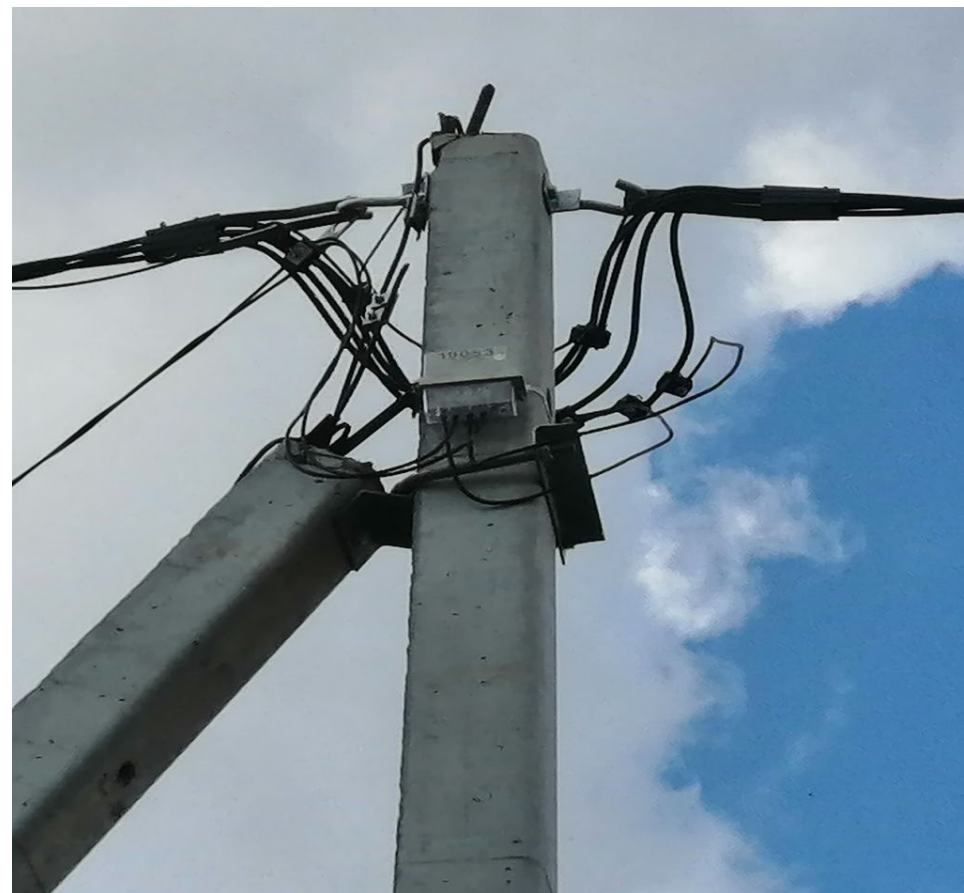
SPLIT-счетчик на опоре
