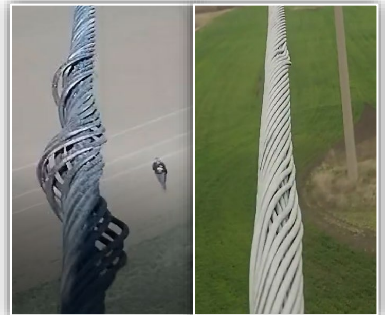
Пример выявленного дефекта (вспучивание верхнего повива)
