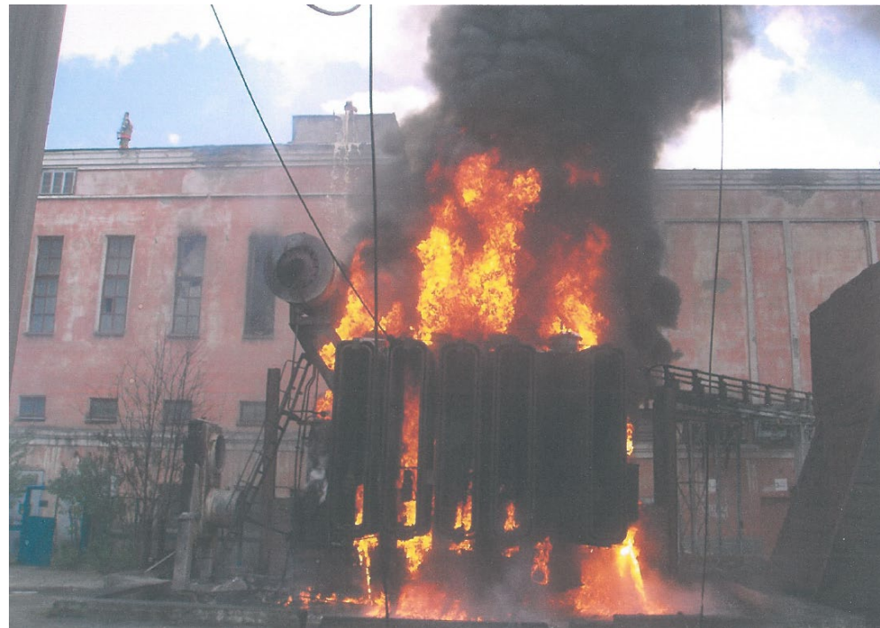
Повреждение силового трансформатора Т-1 ПС 110/10 кВ Ферросплав.
