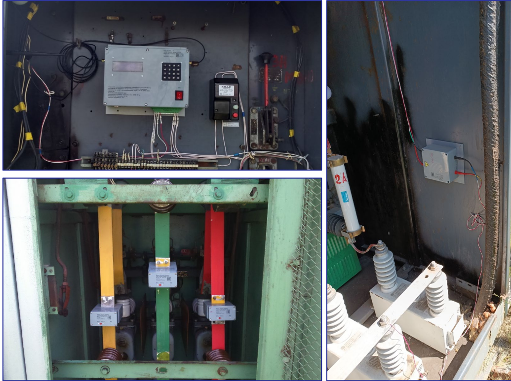
ОПЭ ОМЗ «ВОЛНА – М» на ПС «ПЕТРОВКА»
