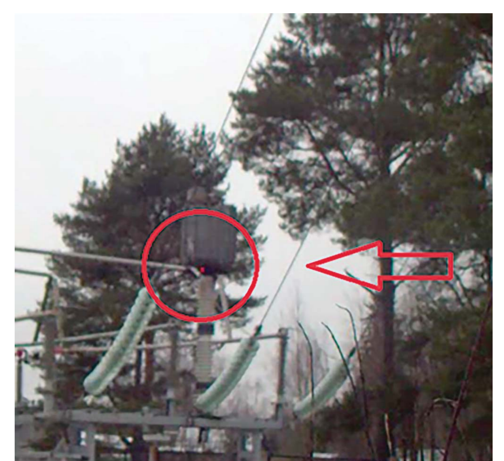
Разряд на дефекте реактора отходящей ВЛ
